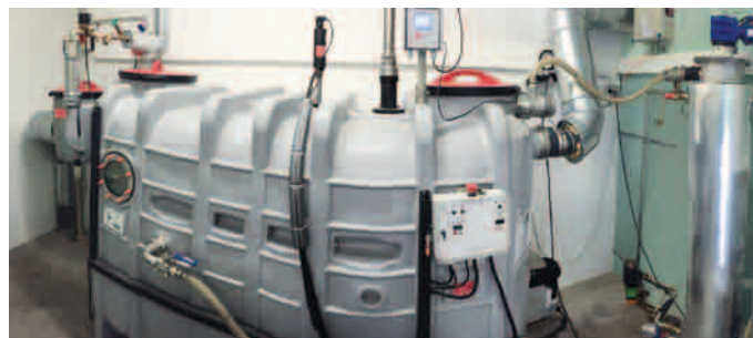
4 Die Anbindung der ACO Liputherm Wärmerückgewinnungsanlage an die Schwimmbadtechnik spart nicht nur fossile Energieträger, sondern auch Kosten.
