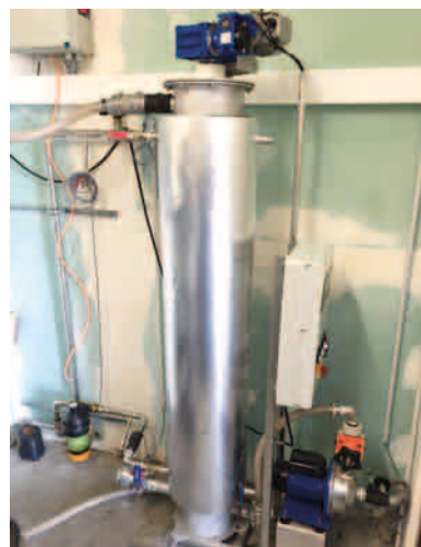
5 Der Wärmetauscher der neuen Wärmerückgewinnungsanlage der BKK Akademie in Rotenburg
