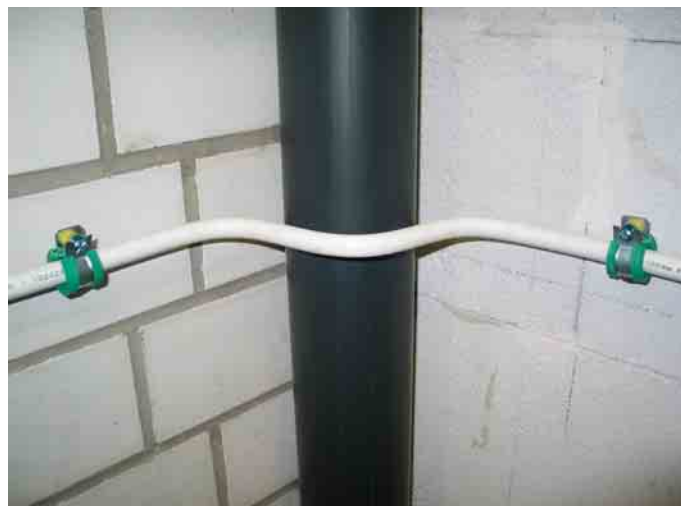
...oder durch Biegen der Mehrschichtverbundrohre ausgeführt werden. So beeinflusst der Installateur die Entstehungskosten. Gleichzeitig wird das Druckgefälle innerhalb der Anlage minimiert.
