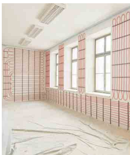
2 Flächennutzung, wie die Normheizlastberechnung sie vorgab: Je nach Raumgröße sind die Wände der Klassenzimmer deckenhoch, manchmal sogar einschließlich Teilen der Zwischenwände mit der Fonterra-Wandheizung ausgestattet.
