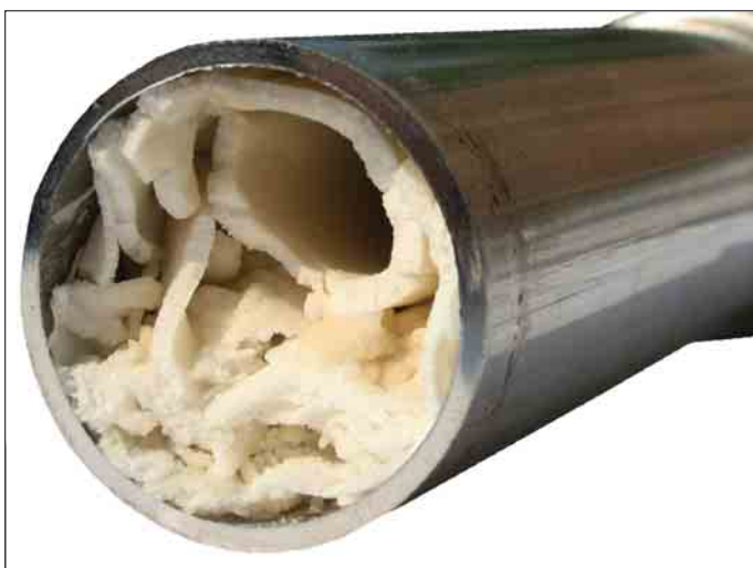
Ob Kunststoff oder Edelstahl: Kalkablagerungen im Rohr können teure Schäden verursachen und bieten darüber hinaus ideale Lebensbedingungen für Mikroorganismen.
