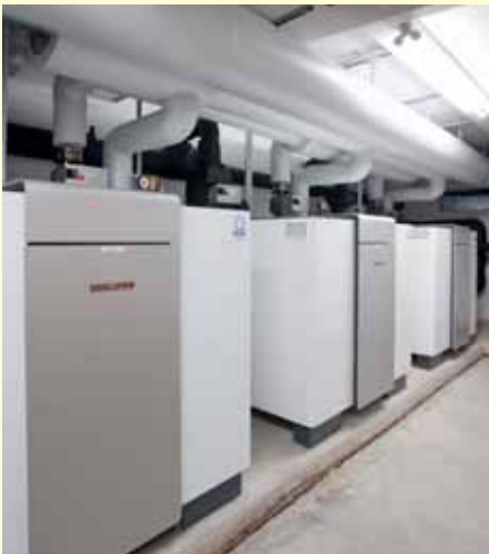
Die vier Sole/Wasser-Wärmepumpen wurden als ein kaskadiertes System realisiert.
