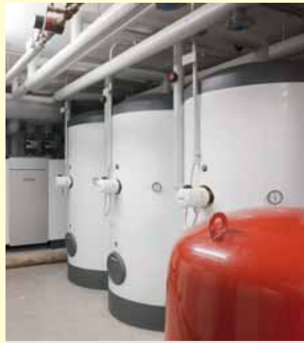
Die drei vorhandenen Warmwasserspeicher der alten Anlage mit jeweils 600 l Fassungsvermögen werden weiterhin genutzt.
