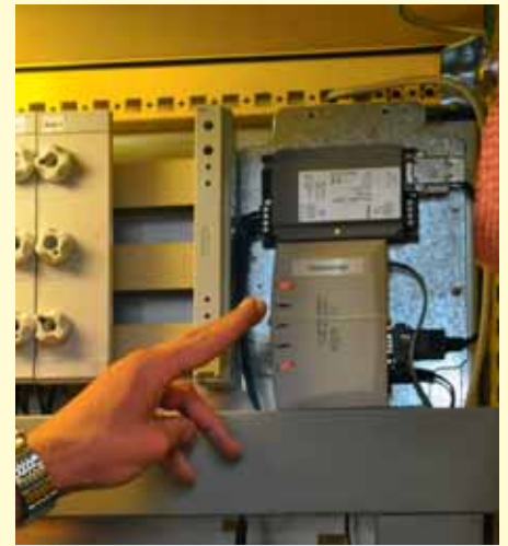
Zusätzlich zur neuen Anlage wurde eine Fernsteuerung installiert, um die Anlage auch von außen fernwarten zu können.
