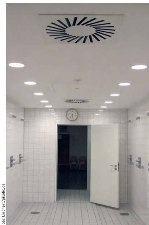
Duschen in Sporthallen sind normalerweise eine besonders gute Brutstätte für Legionellen. Das Foto zeigt die Duschen des FC Bayern München – man darf also annehmen, dass die Haustechnik dort besser in Schuss ist als in vielen Schulsportanlagen.
