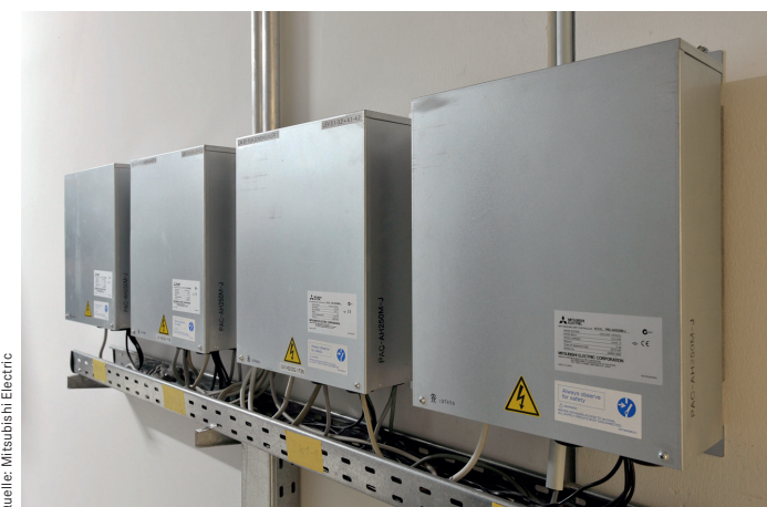
Die jeweiligen Schnittstellen bestehen u. a. aus der Controllerbox, hier in einer Vierer-Kaskadenausführung.
