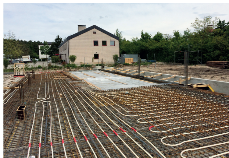
Der betonkernaktivierte Stahlbetonboden wird von der Abwärme der Kühlaggregate gespeist.
