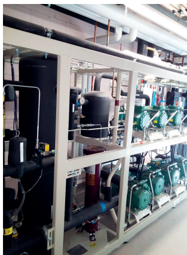
Bei der Kälteanlage des Markts konnte durch die Wahl von CO 2 als Kältemittel das Treibhauspotenzial deutlich gesenkt werden.
