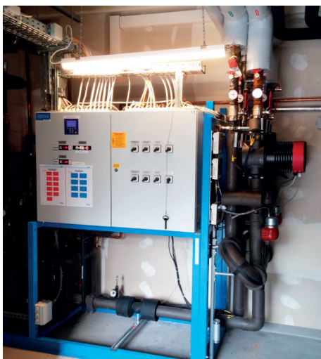
Aufgrund der werkseitig vorgefertigten Hydraulikmodule konnte die Schnittstelle „Kälteanlagenbauer – Installateur“ signifikant vereinfacht werden.
