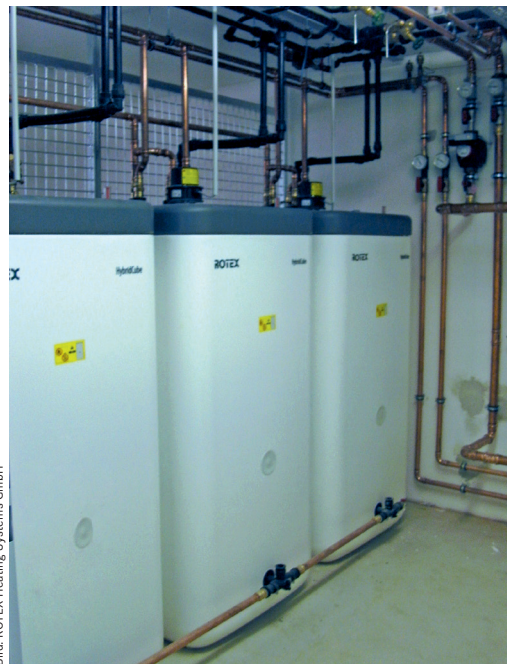
Drei 500 l-ROTEX HybridCube Wärmespeicher versorgen als Kaskade ein Wohnhaus mit sieben Wohnungen mit hygienischem Trinkwasser.
