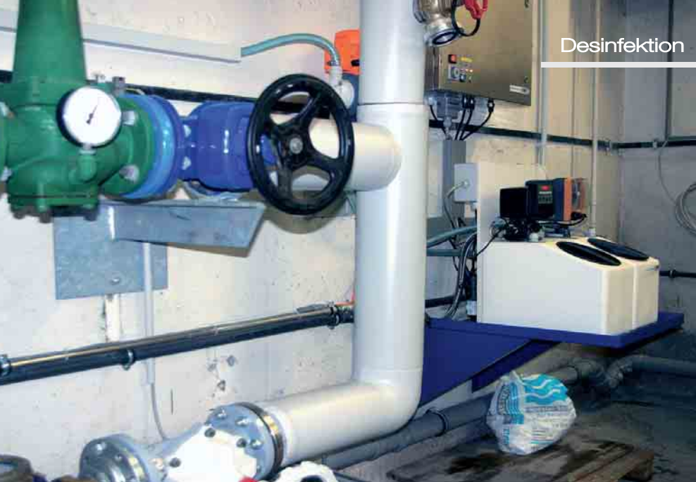
Die IMECA Technologie spart nicht nur Geld, sondern auch Platz: Das wandmontierte Aggregat decontron FX/54 (rechts im Bild) hält das gesamte Trinkwassersystem im Horber Hallenbad lupenrein. Im weißblauen Beutel unter den weißen Kanistern lagern herkömmliche Kochsalzpellets – der Nachschub zur Herstellung der Starterlösung.
