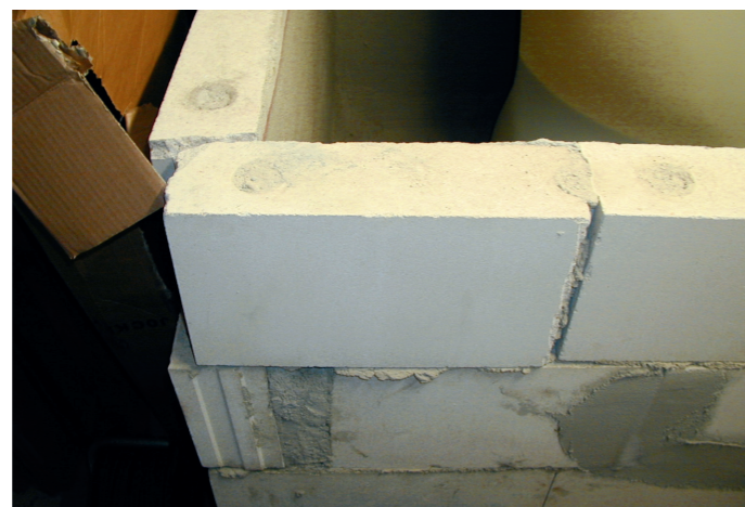
Quelle: ÜWG/Dehoust Eine sichere Abmauerung sieht anders aus. Diese Auffangwanne müsste aufwändig saniert werden.
