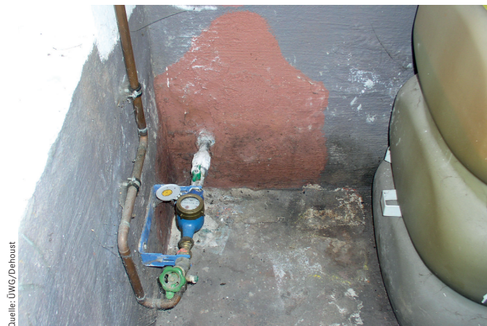
Quelle: ÜWG/Dehoust Abplatzende Farbe und Wasserrohre im Auffangraum sprechen nicht für erhöhte Sicherheit.
