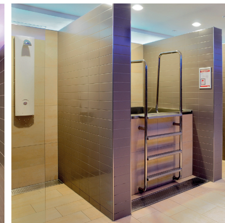
Auch die Entwässerung des Tauchbeckens im Saunabereich erfolgt mit Hygiene-Kastenrinnen aus Edelstahl von ACO Haustechnik.
