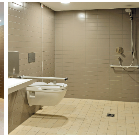
In den Sanitärbereichen des Kölner Just Fit Studios kommen die Bodenabläufe ACO Passavant aus Gusseisen zum Einsatz.
