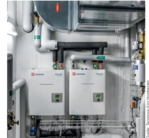
Quelle: Taconova/Urs Homberger Sowohl der Mittelteil des Komplexes, Haus Ciara, dem 800 m² großen Spa-Bereich, als auch das Haus Montagna werden jeweils über eine 2er-Kaskade aus TacoTherm Fresh Peta X-Stationen versorgt.
