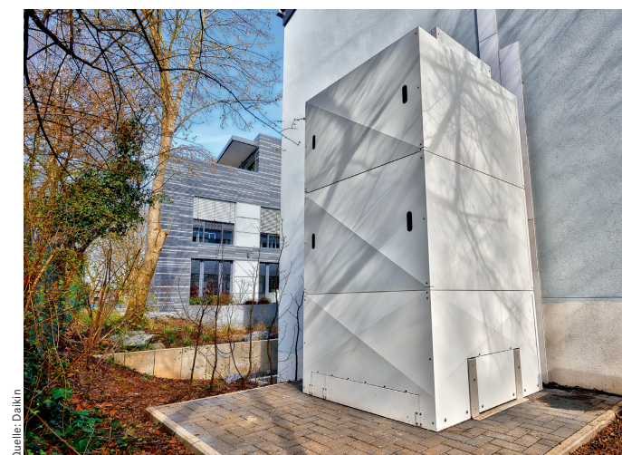
Eine der VRV-Außeneinheiten wurde mit einer Schallschutzhaube versehen, die gleichzeitig auch als Wetterschutz dient.
