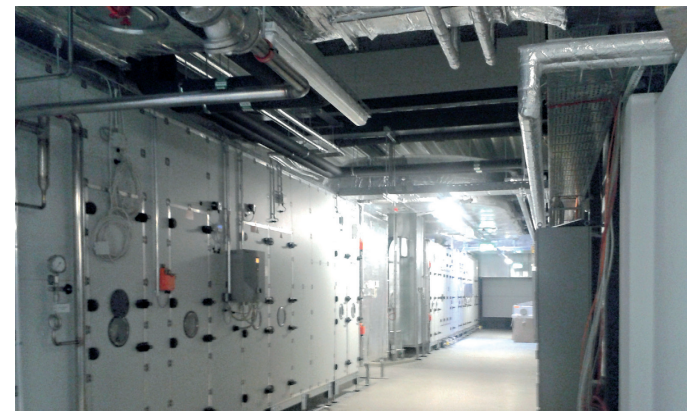
Lüftungszentrale in einem Krankenhaus
