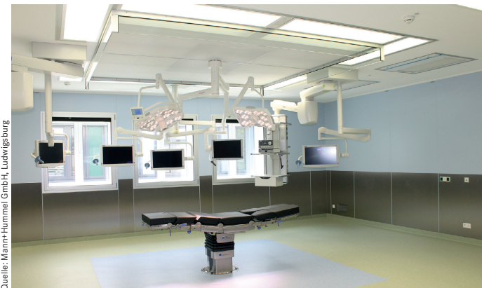
Operationssaal mit dezentralen Deckenumluftgeräten
