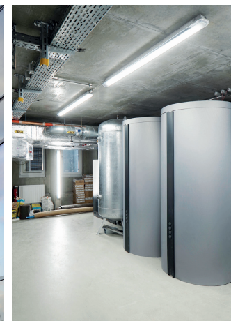
Technikkeller der ETA Fabrik mit Pufferspeicher
