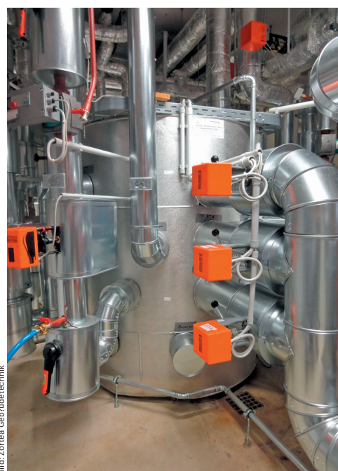
In der Energiezentrale im Fraunhofer-inHaus-Zentrum Duisburg wurde die Kälteverteilung gegen ein Zortea-Verteilerzentrum mit vier Temperaturstufen ausgetauscht.
