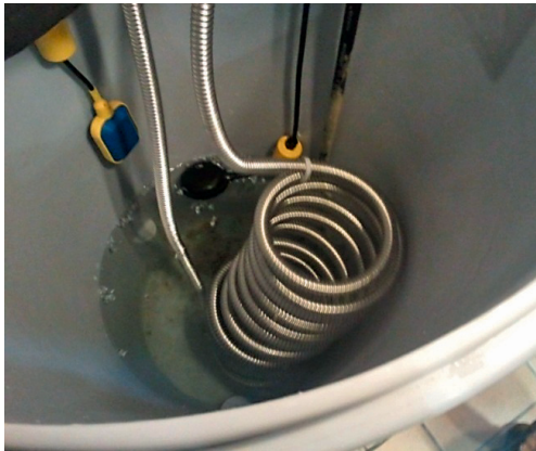
Wärmetauscher in AQUALOOP Grauwasser- anlage
