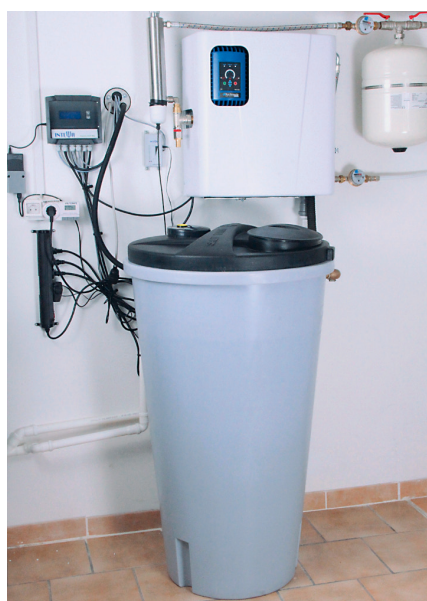
Klarwasserspeicher mit RAINMASTER Favorit SC, AQUALOOP Steuerung, UV-Entkeimung
