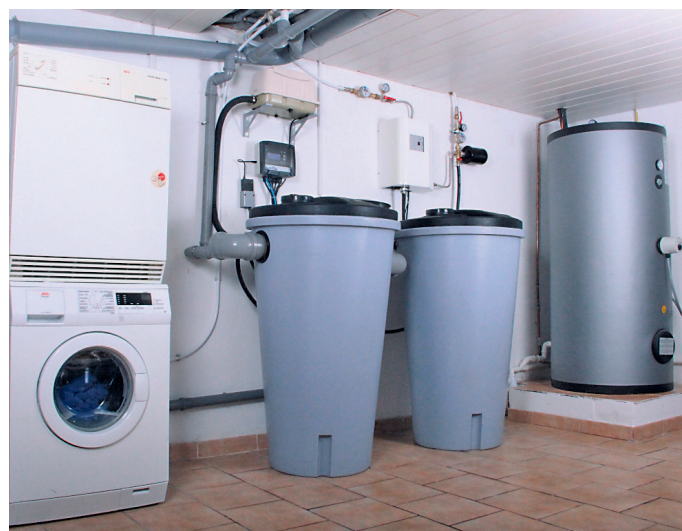
Grauwasserrecycling mit Wärmespeicher (Die Waschmaschine ist an das Regenwassernetz angeschlossen.)
