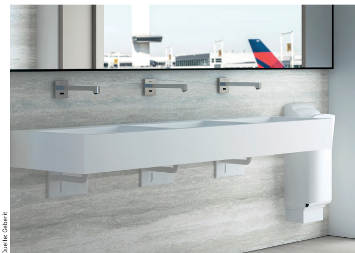
Um die Handkontakte zu reduzieren, sind berührungslose Armaturen mit ausreichend Abstand zum Waschtisch wichtig.
