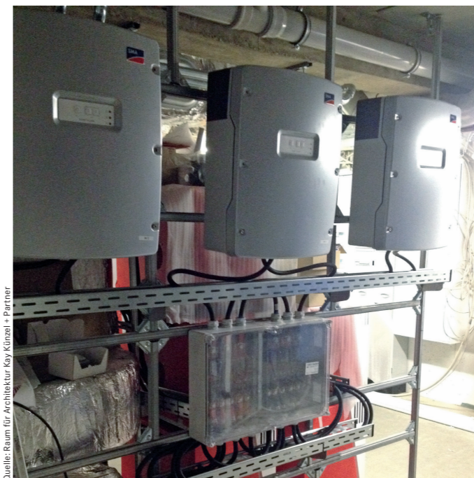
Die fünf in Reihe geschalteten Lithium/Ionen-Stromspeicher (hinten, rot) stellen mit den Wechselrichtern (vorne, grau) die hauseigene Versorgung über Nacht sicher.
