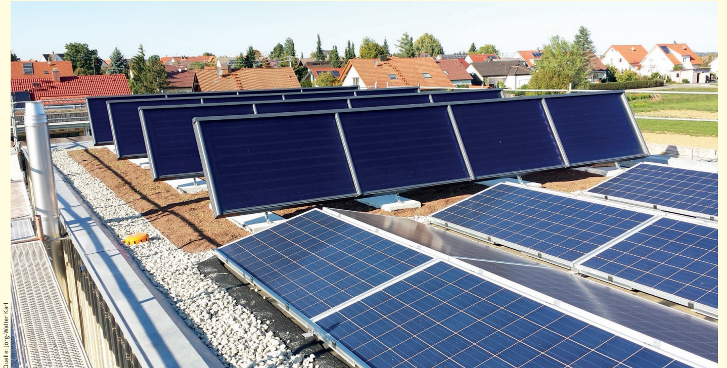
Auf dem Flachdach dieses Sonnenhauses sind Photovoltaik-Module mit 3,72 kWp Leistung und 24 m² Solarkollektoren installiert.
