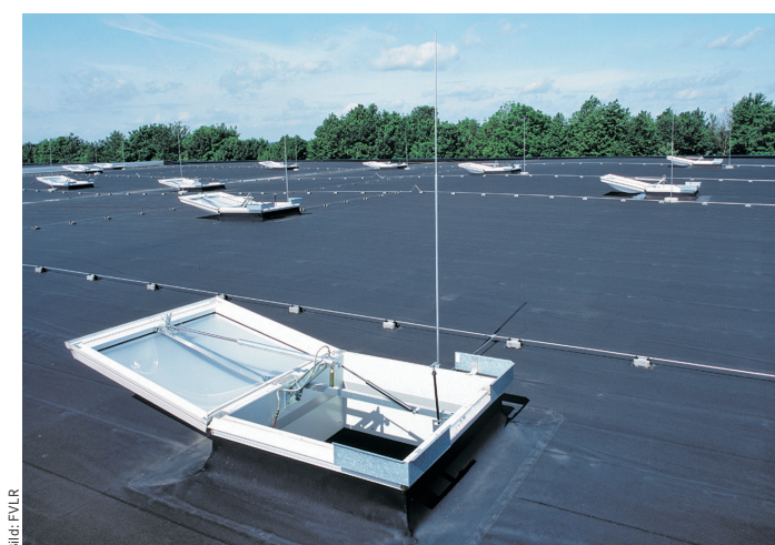
Ein natürlich wirkender Rauch- und Wärmeabzug (NRA). Im Brandfall klappt die Lichtkuppel auf, so dass die durchs Feuer entstehenden Zersetzungsprodukte und die Hitze ins Freie gelangen.
