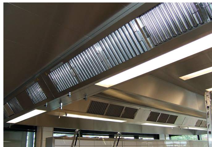
Lüftungsdecke mit selbstreinigenden X-Cyclone-Fettabscheidern
