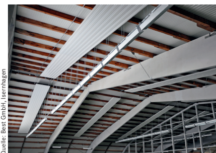
Quelle: Best GmbH, Isernhagen Die Anordnung unter der Decke: Die Strahlbänder wurden zwischen die Holzbinder gesetzt, wobei die Position der Lampenleisten zu beachten war.
