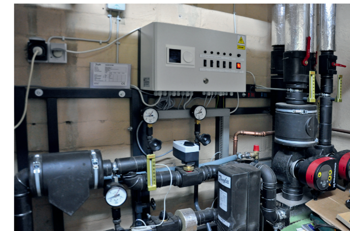
Quelle: Best GmbH, Isernhagen Die Tennishalle ist durch eine Fernwärme-Übergabestation an das Netz der Stadtwerke angeschlossen.
