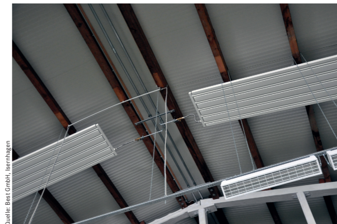
Quelle: Best GmbH, Isernhagen Vom Rücklauf in der Hallenmitte verlaufen die Anbindungen an die DSP mini 28 zunächst mit festen, dann mit flexiblen Anschlüssen.
