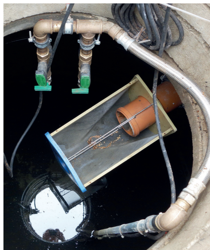
Blick von oben in den unterirdischen Regenspeicher aus Beton. Von rechts Zulaufrohr vom Dach mit einfachem Mall-Gartenfilter, Entnahmeleitung für Gartenbewässerung mit Abzweig und Ventilen
