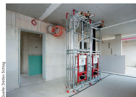
Quelle: Detlev Schlag Zwillingsregister: Ein Register als Basis für zwei WCs in nebeneinander liegenden Zimmern
