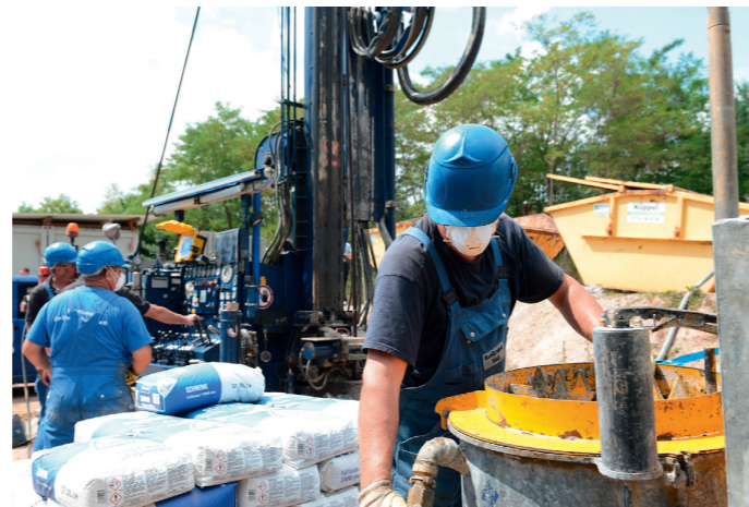
Quelle: Bundesverband Wärmepumpe Erdwärmepumpen (hier im Bild eine auf Basis von Sonden) sind teuer in der Ausführung und sie setzen außerdem entsprechende Genehmigungen voraus. Zum Beispiel sind sie in Wasserschutzgebieten verboten. Das umgeht man mit Luftwärmepumpen.
