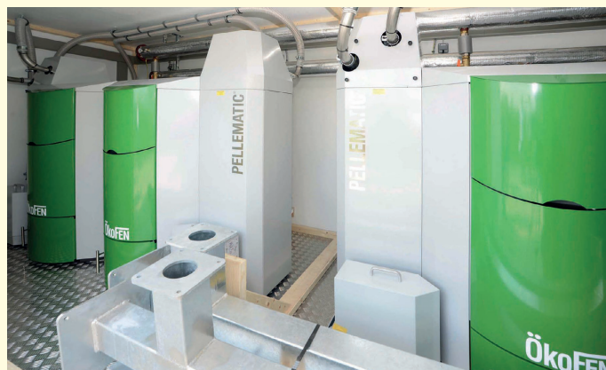
Ein Blick in das Innere des Heizcontainers zeigt, wie Pelletkessel, Lager- und Fördersystem äußerst platz sparend auf kleiner Fläche untergebracht werden konnten.
