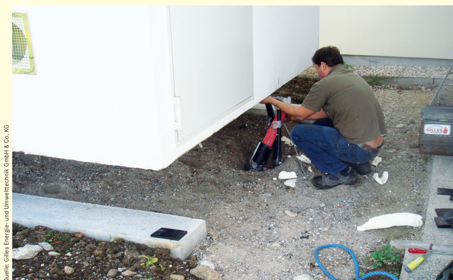
Obwohl die Heizzentralen schlüsselfertig angeliefert werden, ist der Heizungsbauer weiter notwendiger Akteur bei der Installation.
