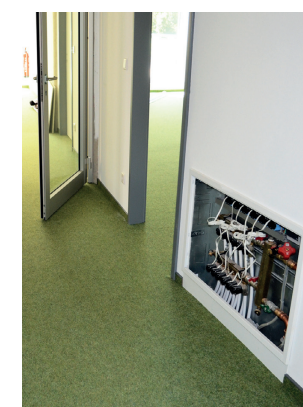
Einer von drei Komplettverteilern in der Sozialimmobilie. Dieser verfügt über neun hocheffiziente Nassläufer-Umwälzpumpen zur energieeffizienten Regelung der Heizkreise, die im Rücklauf (oben) eingebaut sind. Zum eingebauten Verteilerschrank gehört eine Abdeckung, die vor Fremdzugriff schützt.
