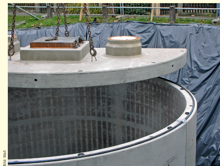
Unterirdisches Pelletlager aus Beton-Fertigteilen, vor Ort verschraubt
