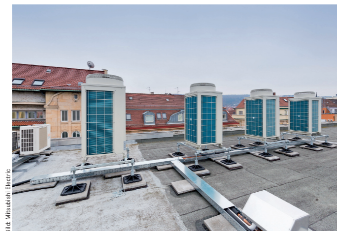
Die vier neuen City Multi Replace Außengeräte arbeiten wesentlich effizienter und umweltverträglicher als die veraltete R22-Klimaanlage.
