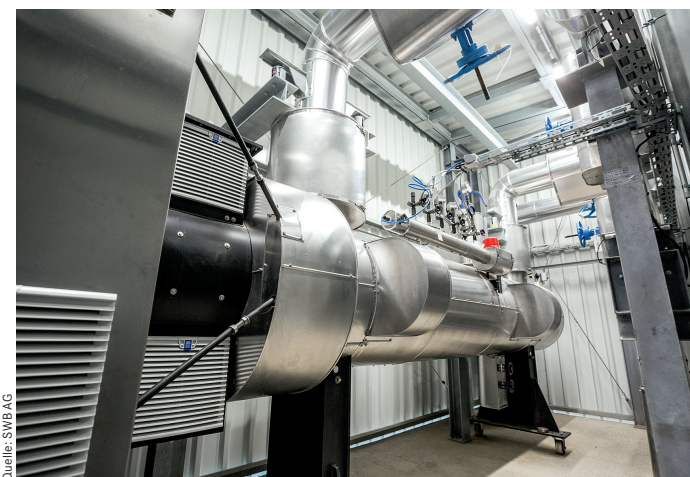
Das Hybridregelkraftwerk, kurz HyReK, gilt bei der SWB AG als weiterer innovativer Baustein zur Energieversorgung.
