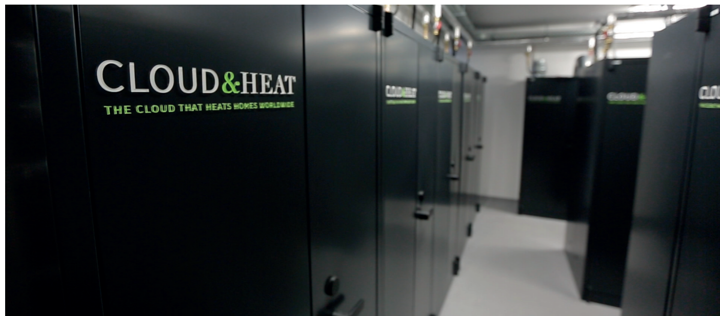
Die Cloud-Server nutzen die Abwärme für die Beheizung von Gebäuden.
