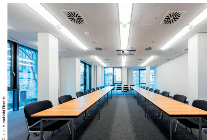
Zwischen den Sitzungs- und Besprechungsräumen kann die Wärme über Kältemittelverteiler bei Bedarf verschoben werden.
