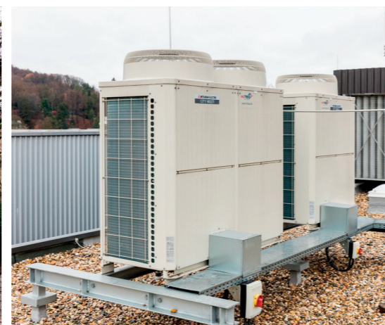
Die beiden Außengeräte aus der City Multi Baureihe benötigen trotz hoher Leistung nur sehr wenig Platz.
