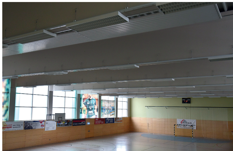
DJK Sporthalle mit moderner Deckenstrahlungsheizung der Firma Sunline
