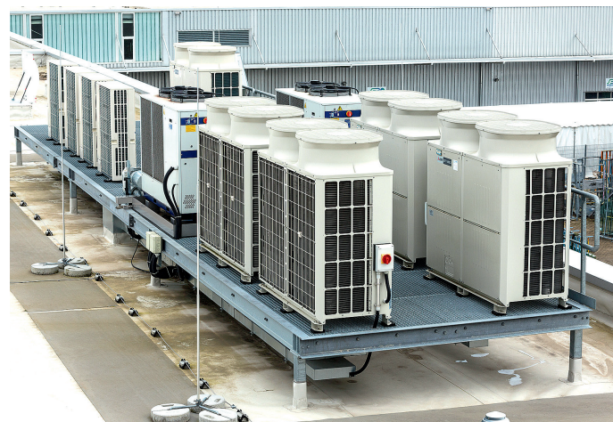
Auf dem Dach des Werksgebäudes befindet sich neben den City Multi-Außengeräten für das R2-System auch die Mr. Slim 4er-Kaskade mit Zubadan Inverter für die raumluftechnische Anlage.
