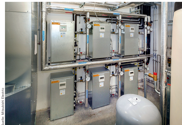
Die überschüssige Wärmeenergie wird zu den sechs Wasserwärmetauscher-Einheiten (HEX-Units) geleitet und dort vom Kältemittel über einen Wärmetauscher auf das Heizungswasser übertragen.
