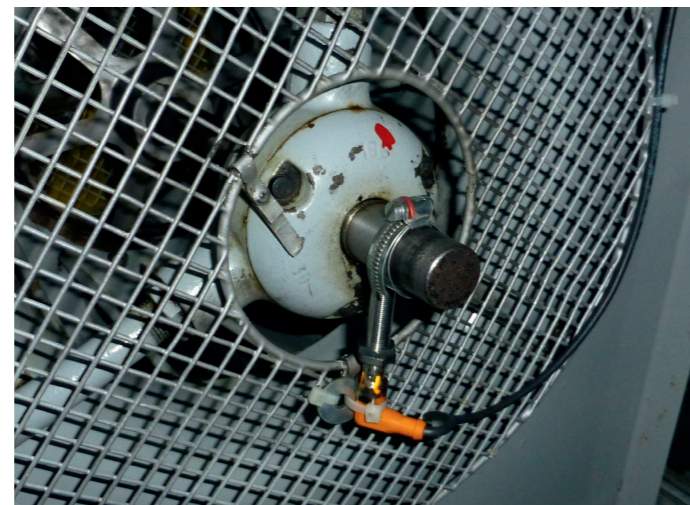
Unsachgemäß montierte und nicht funktionierende Laufüberwachung eines Ventilatorantriebs
