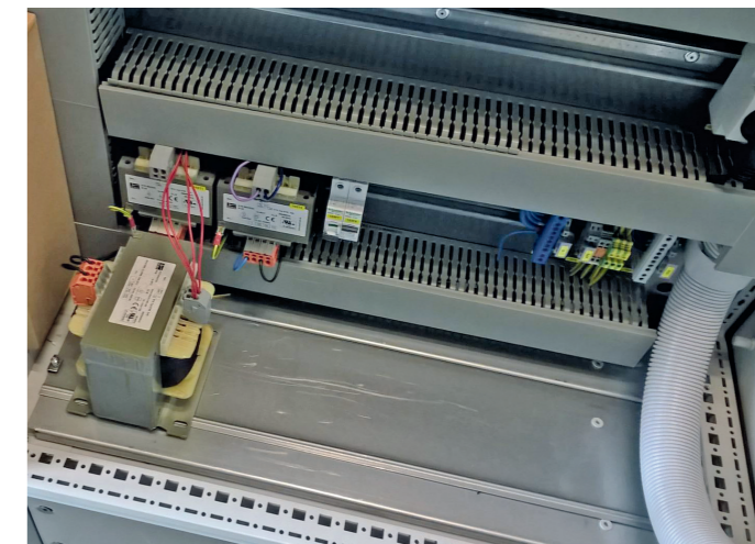
Nicht dokumentierte und nicht fest eingebaute elektrische Baugruppe
