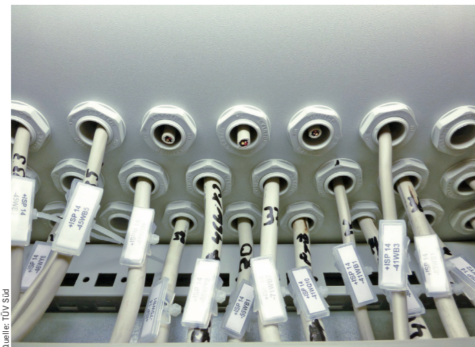
Unsachgemäß rückgebaute Kabel und unzureichender Verschluss der Kabeldurchführungen
