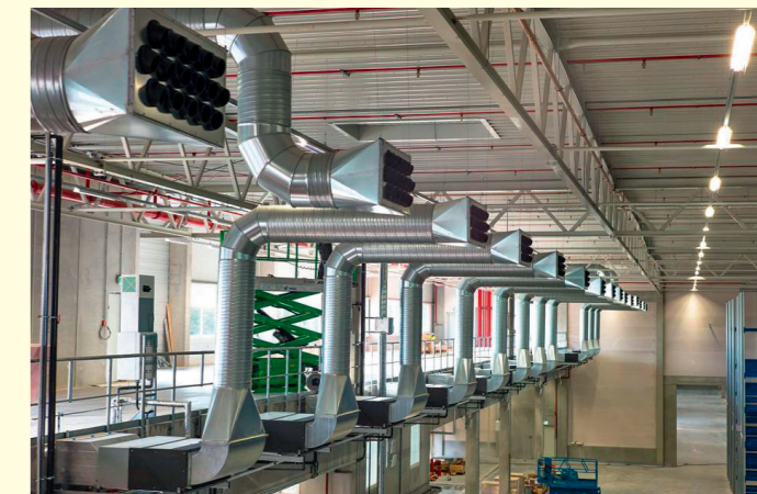
4 – VRV-Innengeräte mit angeschlossener Luftverteilung
