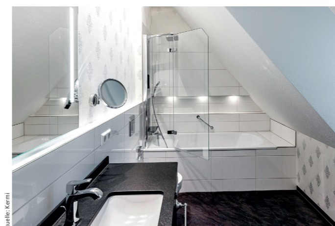
Raum sparend und wie eine vollwertige Duschkabine: die Gia XP als Badwannenaufsatz, auf Maß gefertigt und angepasst an die Dachschräge
