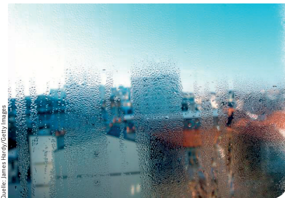
Bildung von Kondenswasser. Das Risiko für Schimmelbefall ist hoch.
