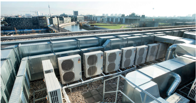
44 Außengeräte der Mr. Slim Serie versorgen die Zuluft der Lüftungsgeräte mit Wärme oder Kälte – je nach Bedarf.
