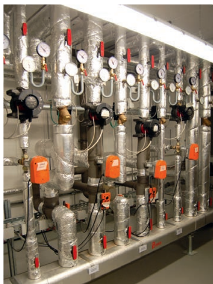
Über die Heizkreisverteiler ist die Multi-Boden-Heizung mit der R2-Anlage verbunden.
