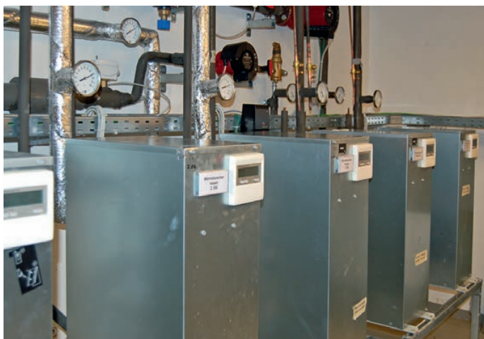
Insgesamt fünf Hex-Units unterstützen im Keller den Wärmeübertrag von der Klimaanlage auf das Heizungssystem.
