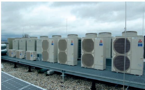
Mit unterschiedlichen Gerätetypen wird die Energie zum Heizen und Kühlen effizient aus der Außenluft gewonnen bzw. an diese abgegeben.
