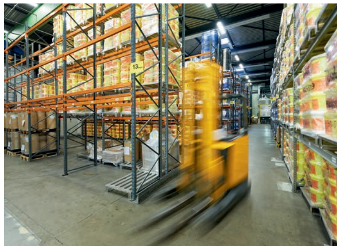
Im Arweilerlager werden die sechs Hochregallagergänge jeweils mit einem frei hängendem Kanaleinbaugerät klimatisiert.
