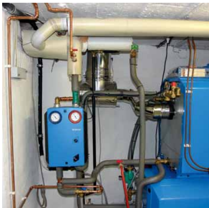
6 – Hier wurde ein Platz sparender Aktiv+ installiert (links im Hintergrund).
