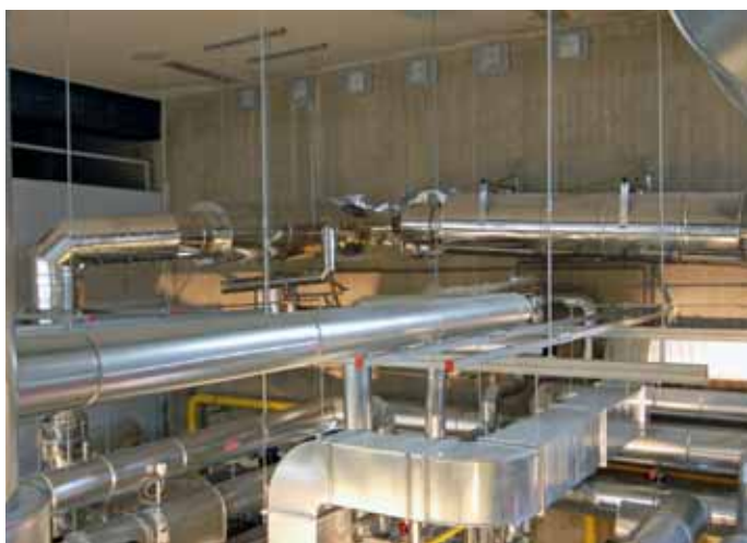
4 – Bei der Großanlage wurden nach Messungen und individueller Auslegung verbaut: Für den Pelletkessel ein Einkammer-TTS mit einem Passiv-Schalldämpfer-Anteil; die Baulänge inklusive Stutzen beträgt 2.070 mm (links im Bild). Für den Gaskessel wurde ein Zweikammer-TTS mit einem Passiv-Schalldämpfer-Anteil verbunden. Hier beträgt die Länge mit Stutzen 2.770 mm.
