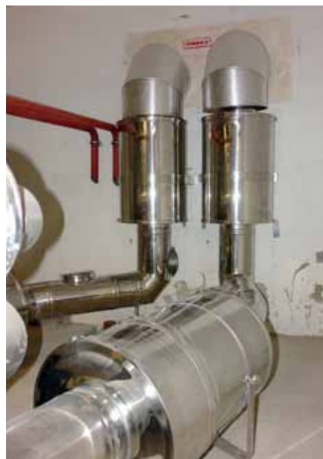
3 – In dieser Anlage wurden in beiden Abgasanlagen jeweils ein Tiefton- und ein Passiv-Schalldämpfer installiert. Hier sind die Komponenten noch ohne die Dämmschalen zu sehen.
