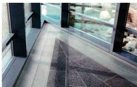
⑨ Bodenkanalheizung mit Gehrungsecke im Verwaltungsgebäude Deutsche Bahn AG, Berlin
