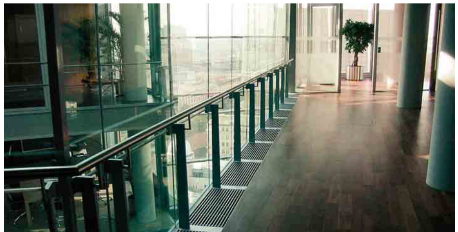
13 Quellluftauslass mit Konvektor im Uniqua Tower Wien
