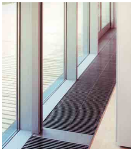
⑧ Unterflurschacht mit Mittenabdeckung im Verwaltungsgebäude HUK Coburg
