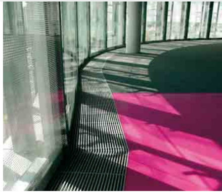
10 Bodenkanalheizung vor polygonaler Fassade im BTU Cottbus (Bibliothek TU Cottbus)
