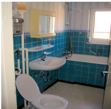
Altes Bad und antiquierte Druckspülung vor der Sanierung
