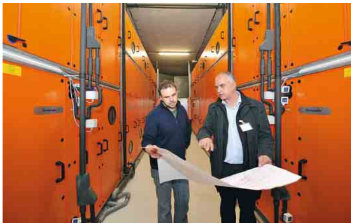
Für die verbleibenden Bereiche (Aufenthaltsräume, Gänge usw.) der Landesbehörde wurden Zentralklimageräte mit zweistufiger Wärmerückgewinnung eingesetzt. Frank Rehfeld und Jörg Schulze besichtigen die Anlage.
