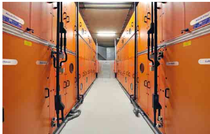
Die Lüftungsanlage für die sonstigen Räume ist neben der Gebäudeleitstelle im Untergeschoss untergebracht. Die strikte Trennung von Zu- und Abluftströmen sorgt dafür, dass die hohen Hygienestandards im Landesamt eingehalten werden können.
