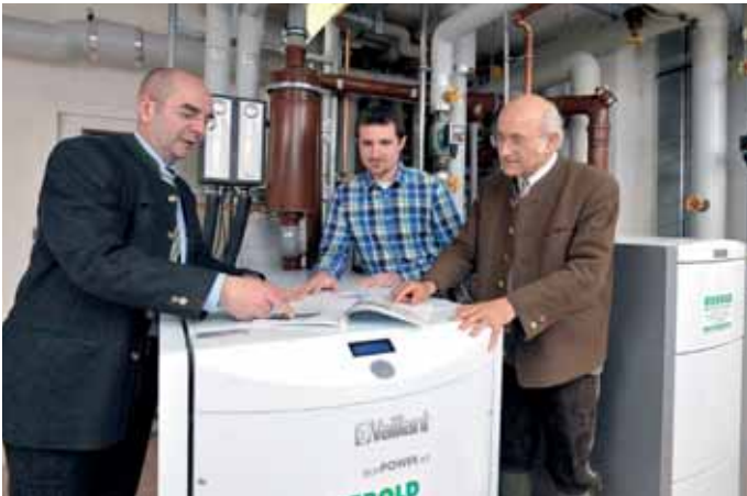
Vaillant Vertriebsingenieur Georg Rehm (links), SHK-Unternehmer Stefan Gerold (Mitte) und Schlossherr Dr. Sixtus Lampl im Gespräch zu den Anlagendetails der neuen Heizzentrale.
