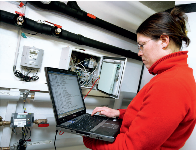
Einstellung der Systemparameter im Heizungskeller
